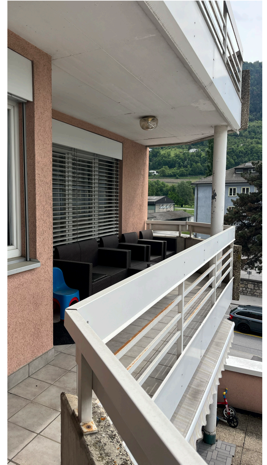
Balcon trop exposé
